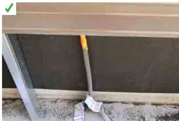
La gaine d'alimentation de l'éclairage extérieur passe ici à travers la dalle béton afin d'éviter les percements des plans d'étanchéités de l'ossature bois. ©AQC
