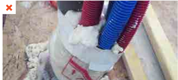
Mauvais traitement de la traversée du plan d'étanchéité à l'air d'un plancher bas. ©AQC
