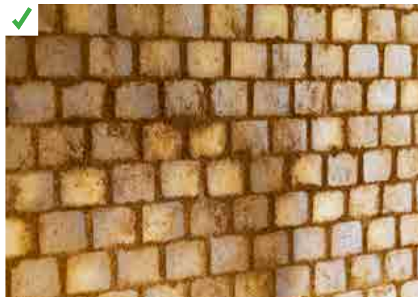
Augmentation de l'inertie thermique du bâtiment avec la mise en place d'une paroi intérieure en terre crue. ©AQC
