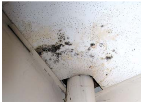
Moisissures sur un plafond humide (fuite de canalisation).
